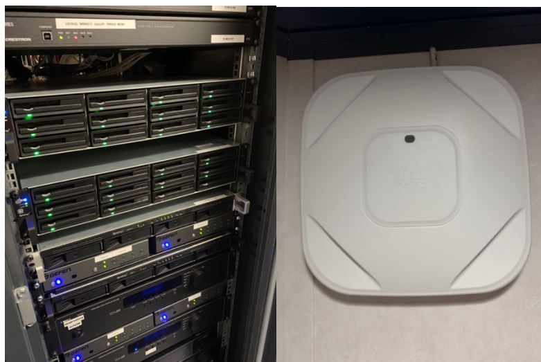
Annexe 42 : Baie de stockage et contrôleur wifi Cisco
