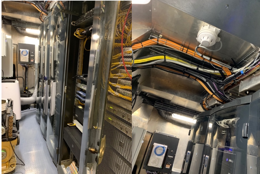
Annexe 41 : Salle serveurs
