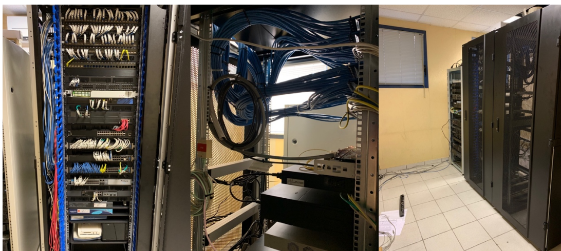
Annexe 33 : Câblage terminé
